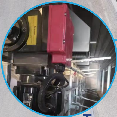
Tunnel door ventilation
